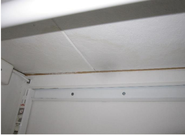
Fuktrosor i sovrumsstak
