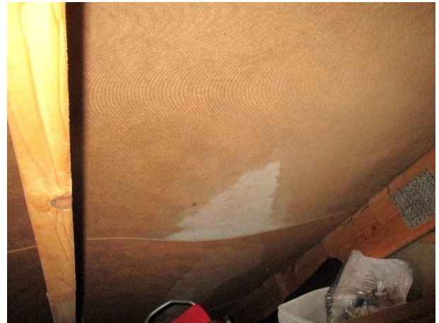
Missfärgningar/fuktgenomträngningar längs yttertakets insida
