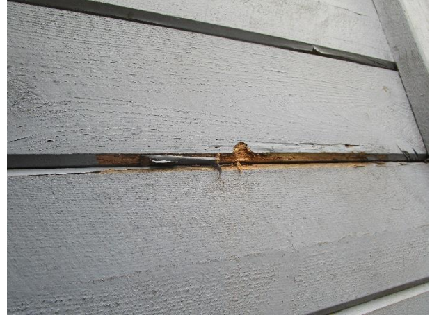
Rötskador i fasadens panel
