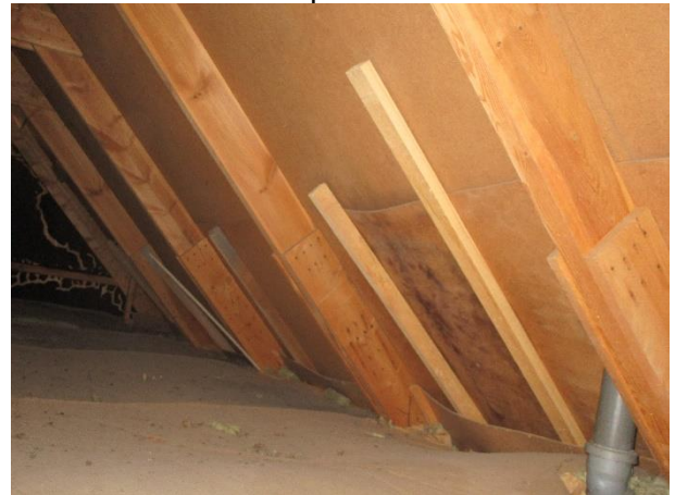
Det finns fuktgenomträngningar längs yttertakets insida
