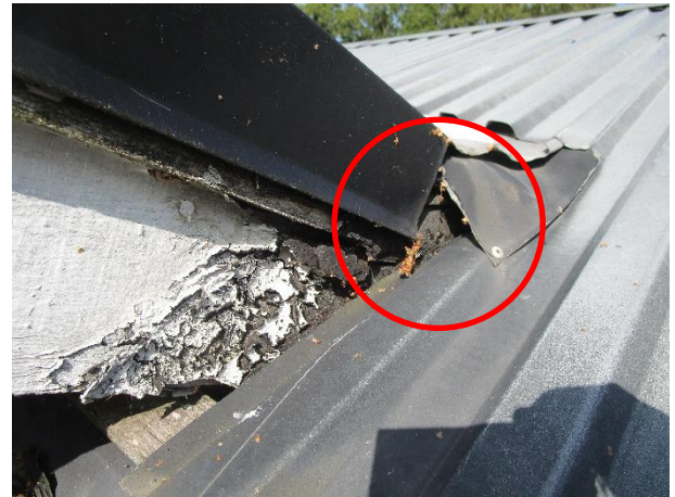
Täckplåt saknas vid ränn dal
