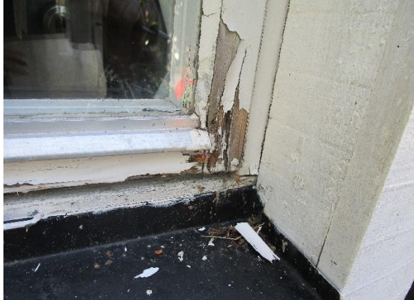
Eftersatt underhåll på fönstren
