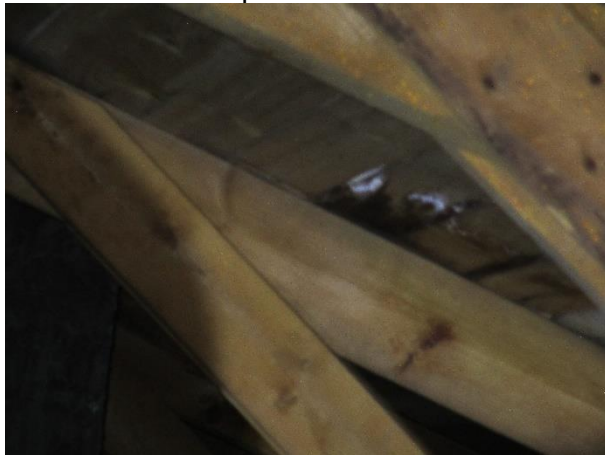
Fuktgenomträngning längs yttertakets insida
