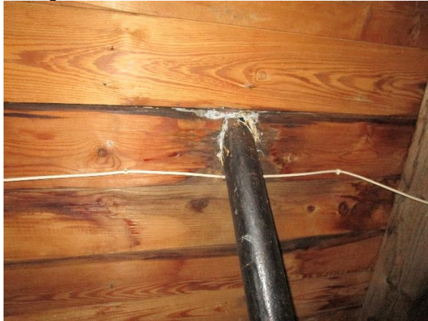
Det finns fuktgenomträngningar längs yttertakets insida
