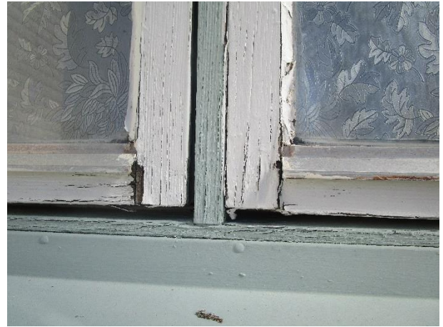
Fönstren har ett eftersatt underhåll
