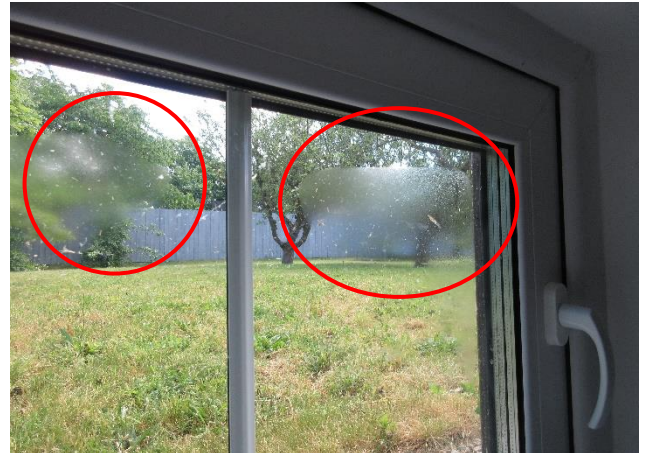
Kondens i treglasfönster i sovrum 1 på källarplan.
