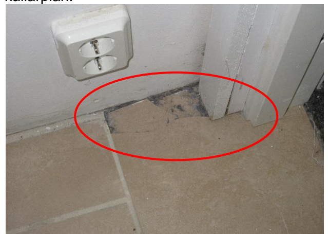
Trasig klinkerplatta på golv utanför sovrum 2 på källarplan.
