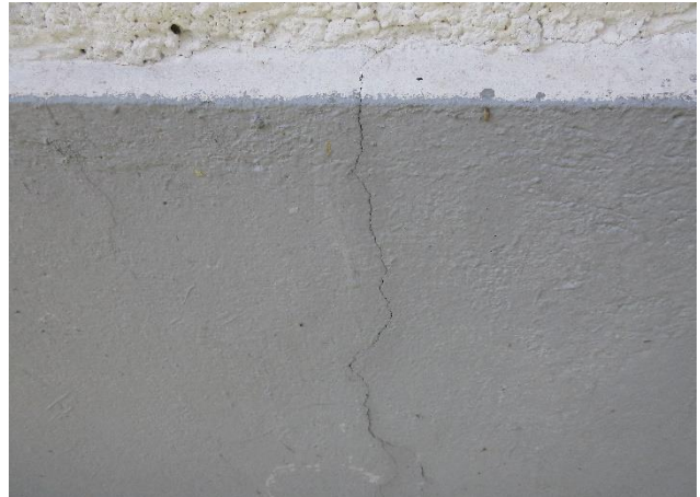
Sprickor i hussockeln.
