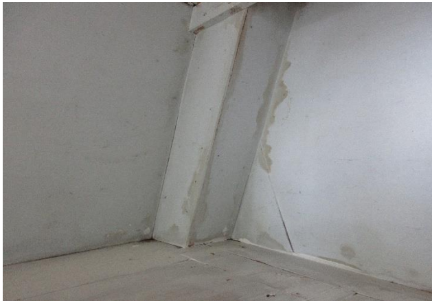
Missfärgningar på masonitboardens insida i garderober på övre plan.
