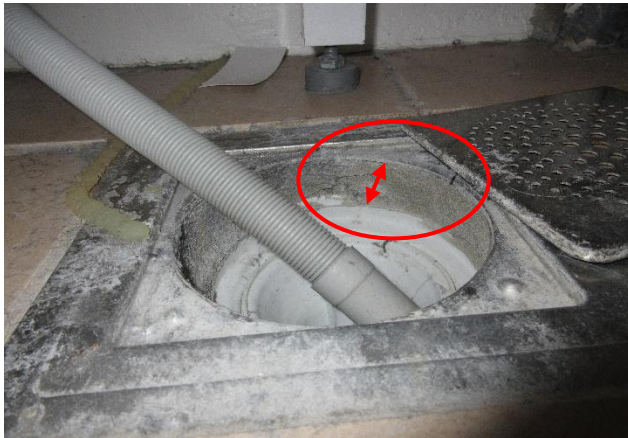
Tätskiktets anslutning till golvbrunnen är inte besiktningsbart, på grund av att fix och fog täcker anslutningen i tvättstuga på källarplan.
