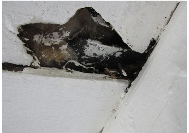
Rötskada på yttertaketets insida i vindsrummet.
