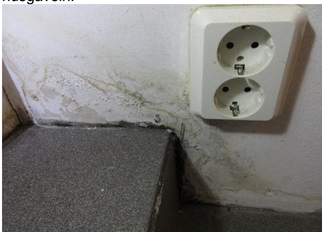
Det finns fuktmissfärgningar på väggar ner mot golv på källarplan.
