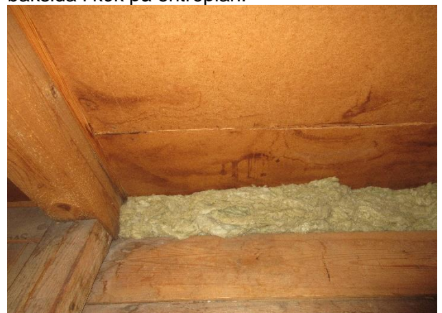
Missfärgningar på masonitboardens insida i kattvin.
