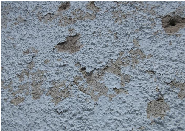
Putssläpp och synlig armering på den södra husgaveln.
