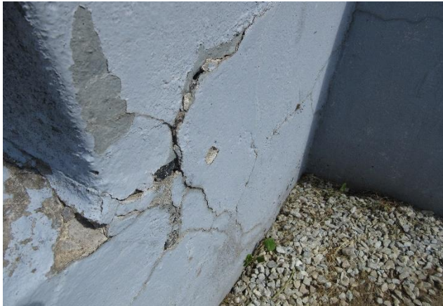
Frostsprängningar i entrétrappan.
