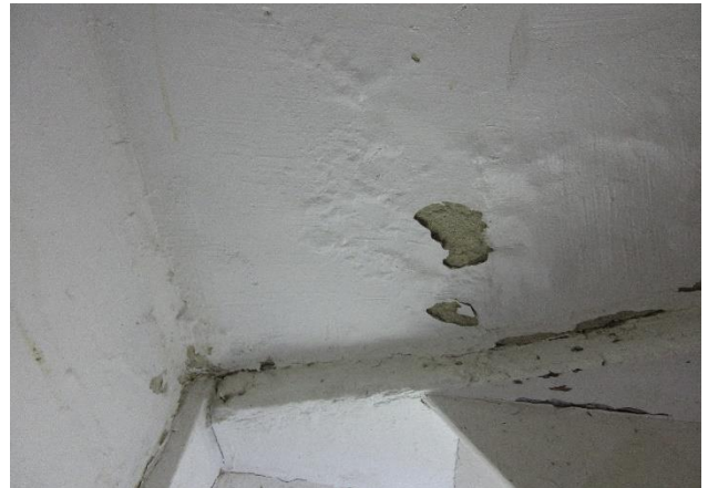
Färgsläpp i trappa längs yttervägg. På källarplan.
