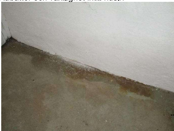
Fuktgenomslag längs golv och vägg
