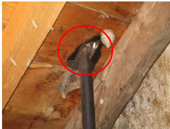
Tätning bristfällig vid rörgenomföring
