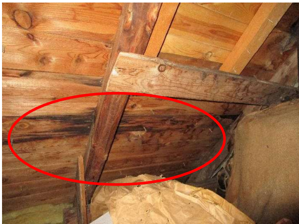
Fuktgenomträngningar längs yttertaketets insida
