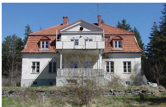
Förvaltarvillan ca 2005, försvarsmakten har lagt ned verksamheten och underhållet är mycket eftersatt.
