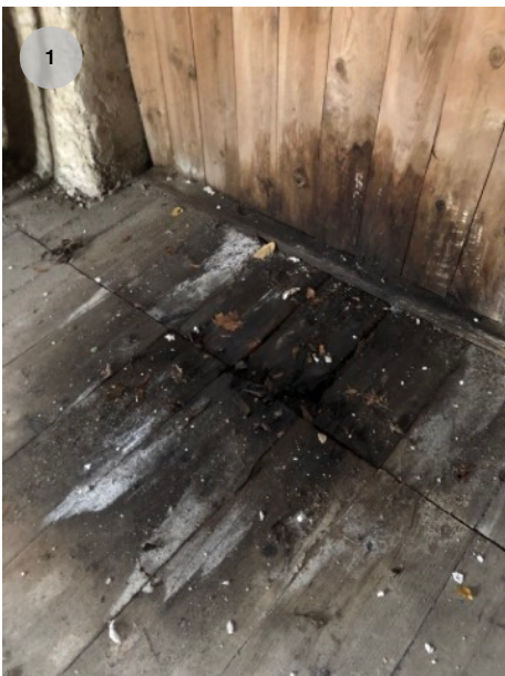
Murket virke i golv. Bjälken som går inunder har påverkats. I ytterkanterna av missfärgningen har virket fortfarande kvar kärna.
