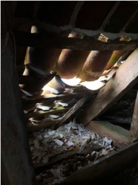
Ett av de ställen på vinden där taket är i sämst skick. Läkten har brustit och tegelpannorna vikts in.
