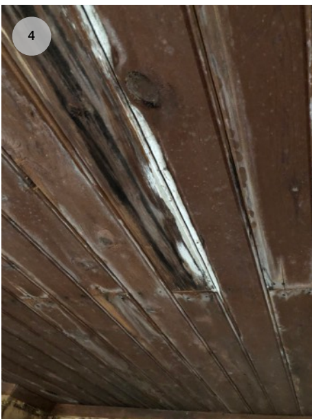
Fukt och mögelskador i taket i vindsrummet
