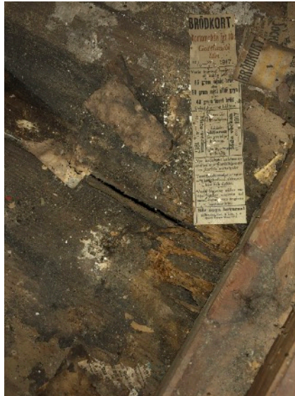
Skadat golv i garderob i vindsrummet
