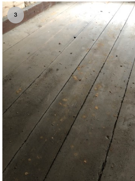
Förmodligen aktivt insektsangrepp i vindsrummet
