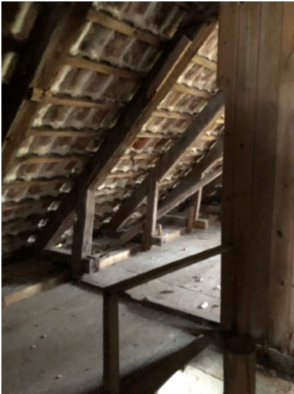
Taket på den "bra" sidan. Även den i behov av undermurning
