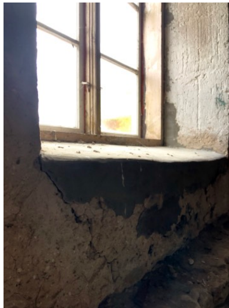
Cementlagning i fönster som bör åtgärdas
