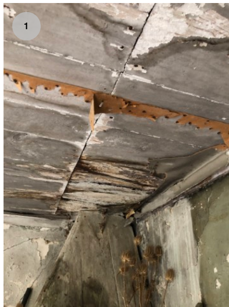
Tak i köket under skadan. Fuktangrepp på takpanel.
