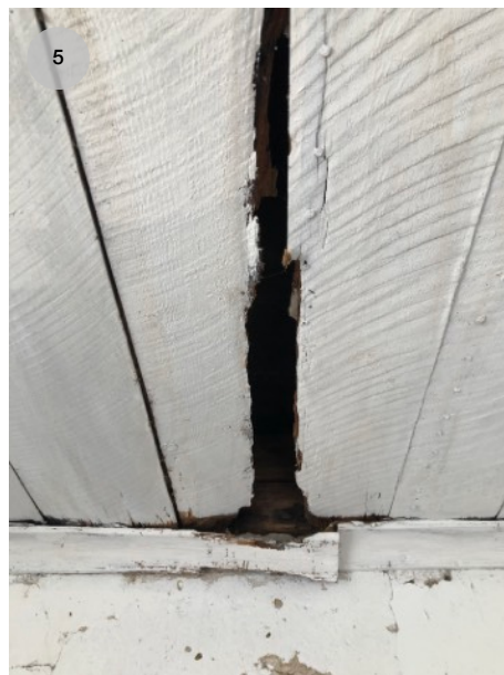
Vattenskada i kammaren, till följd av vattenläckage i taket
