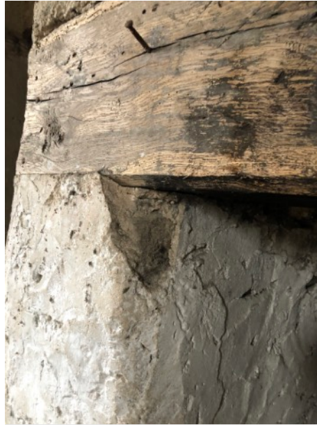
Detaljbild på skada i putsen
