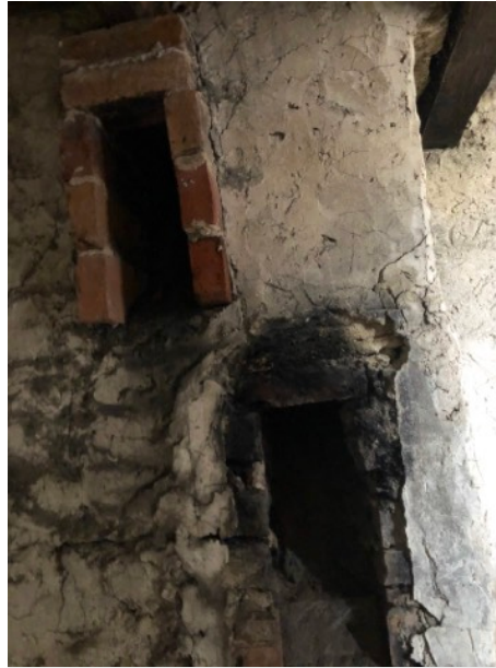
Rökkanaler till grytan. Mindre skador i putsen.
